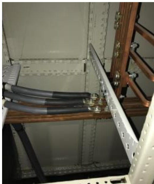
Bild 3. Inkoppling i servis efter elmätaren
