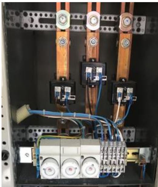
Bild 4. Inkoppling av strömmätning logger
